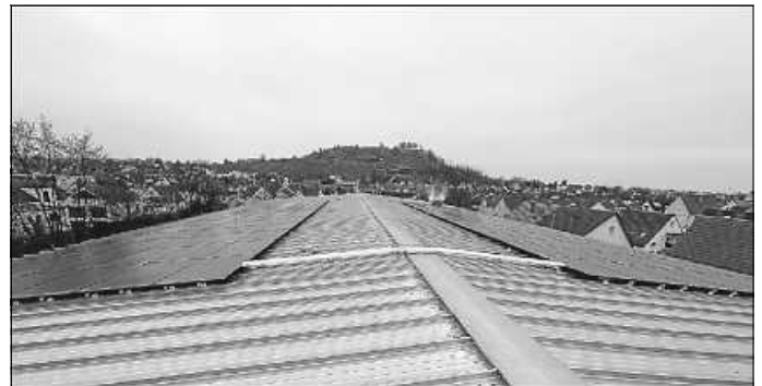
Neue PV-Anlage auf der Stadthalle
