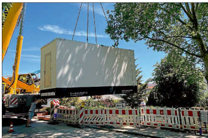
Ein Schwergewicht wird platziert: Die SWLB hat in Asperg den ersten Knotenpunkt für gigaschnelles Internet aufgestellt. Foto: SWLB
